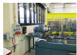
TR4 Lab. de Fluids Instal·lació de grups hidràulics.
