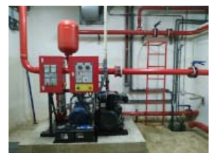
TR4 Nova instal·lació grup contra incendis.
