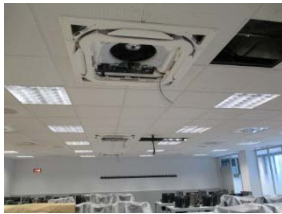
TR12 Reforç de clima amb màquines noves a l'espai S08.
